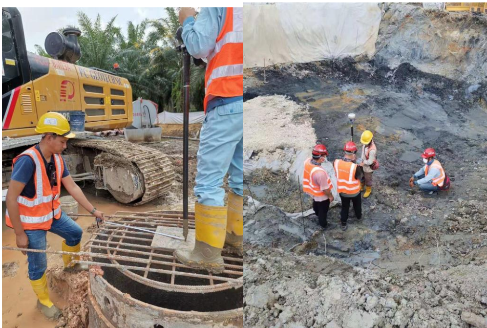
图 4-1：学生在“一带一路”重点项目（马来西亚马东铁项目部）工作场景
